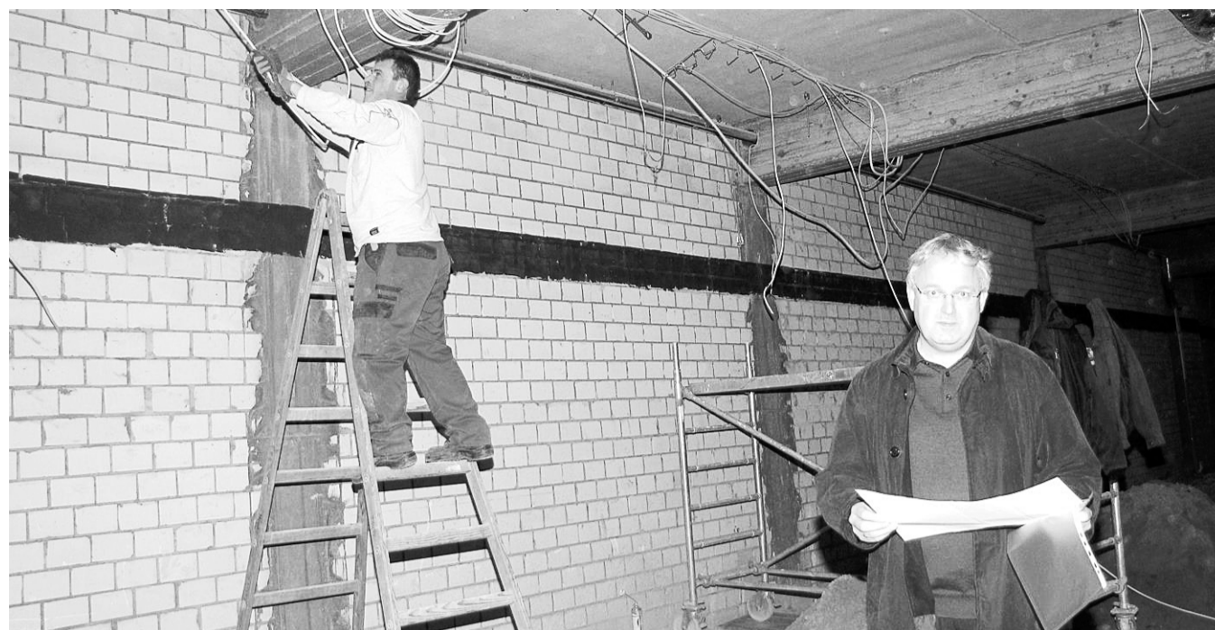
Immobilienmakler Hubert Maas (r.) mit den Plänen für die künftige Gestalt des Gebäudes an der Lange Straße. Handwerker installieren neue Versorgungsleitungen. Der erste neue Nutzer ist gefunden, weitere werden gesucht. Foto: ude
